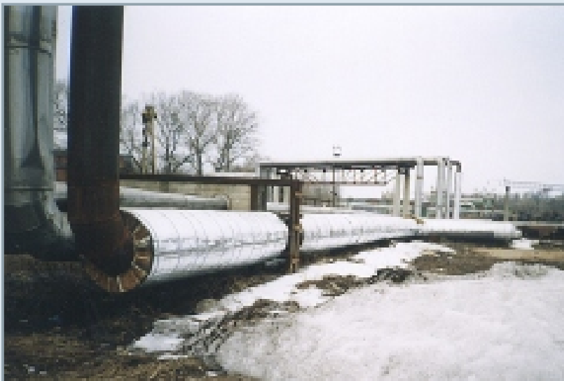
Изоляция паропроводов, рабочая t +250^{\circ}\text{C} Смоленская ТЭЦ-1.
